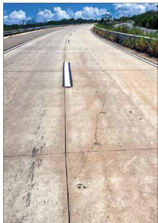
Fissuras longitudinais em pavimento de concreto em rodovia federal. Fonte: DNIT
